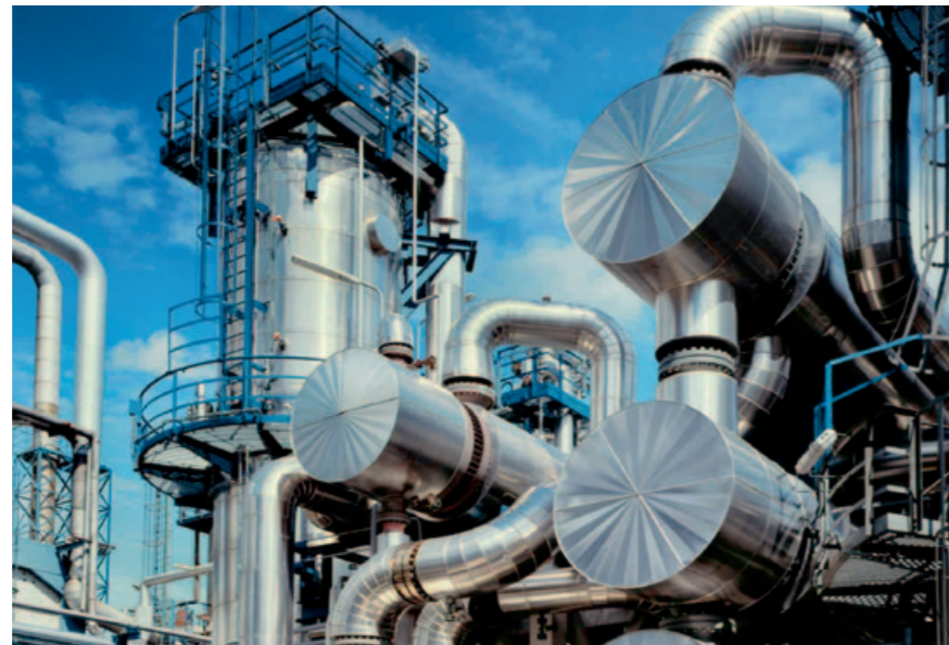
Hochmoderner Plattenwärmetauscher auf dem Raffineriegelände zur „Einsammlung“ der Prozessabwärme
