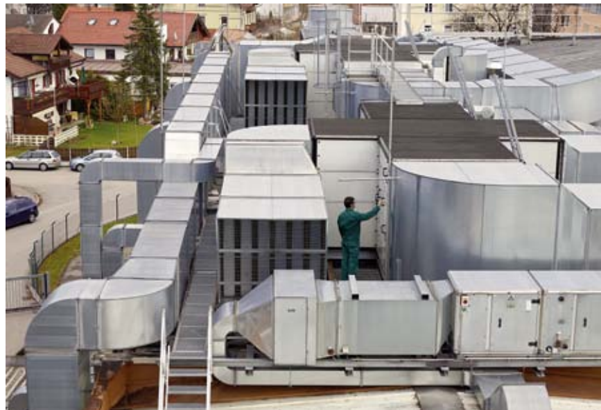
Nachgerüstete Lüftungsanlage mit hocheffizienter Wärmerückgewinnung.
