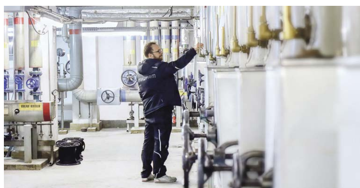
Hohe Präzision bei Wärmepumpen-Auslegung und hydraulischem Abgleich dank Messverfahren
